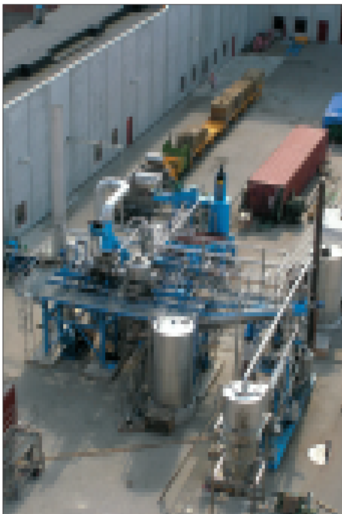
Figur 1. Oversigtsbillede af IBUS-forbehandlingsanlægget på Fynsværket.
